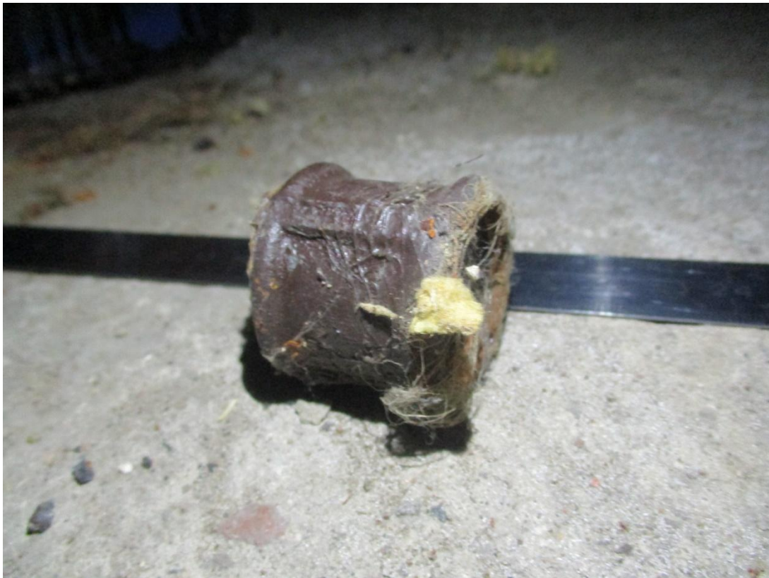
Обнаруженный экспертом под трубопроводом сгон, который вероятней всего ранее был установлен на данном участке трубы ЦО.
