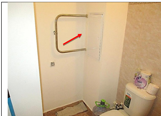
Общий вид сантехнического шкафа в санузле.
