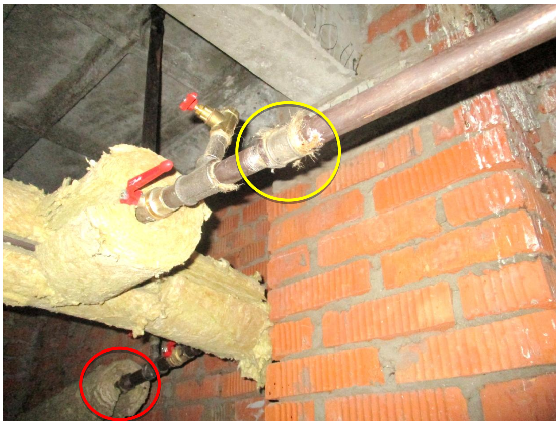
Вид системы ЦО снизу. Желтым кружочком выделен замененный сгон, красным сгон на аналогичном участке трубопровода, смонтированный изначально.
