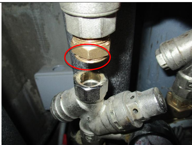
Разрушение ниппеля на резьбовом участке.
