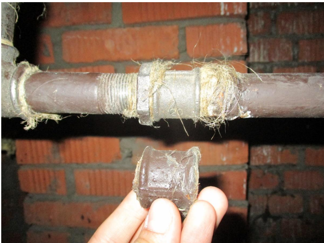
Фото участка трубопровода с замененным сгоном и сгон, обнаруженный экспертом под трубопроводом, который вероятней всего ранее был установлен на данном участке трубы ЦО.
