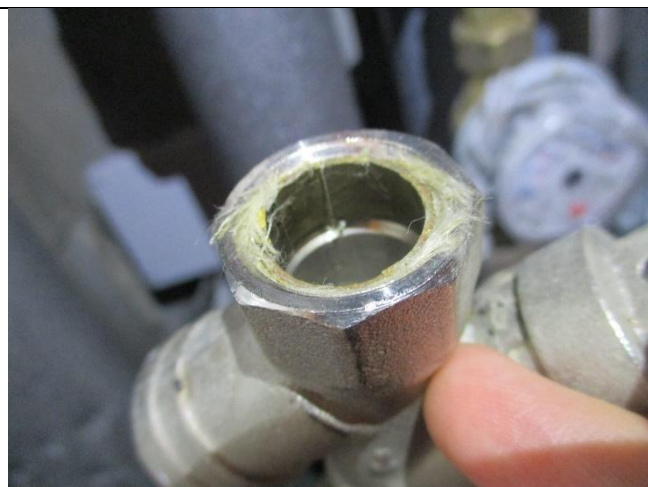
Часть ниппеля, оставшаяся в регуляторе давления.
